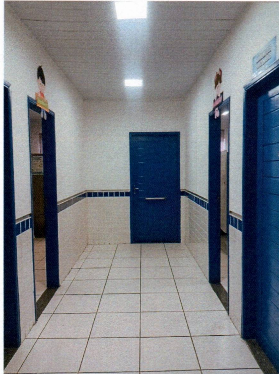
Imagem 7 – Pintura interna, pintura das esquadrias de madeira e substituição do revestimento cerâmico 45x45 dos comodos da escola
