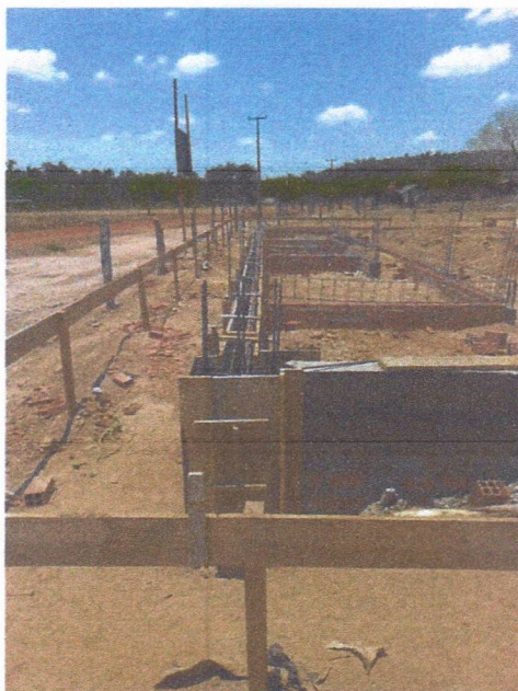
Imagem 5 – Execução da armação da viga baldrame e montagem das formas de madeira.
