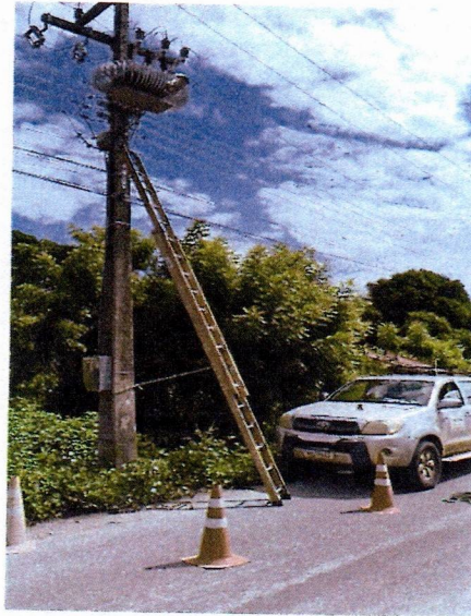
Figura 07: equipe em campo realizando substituições necessárias de Lâmpadas, cabo elétrico, conector, reator, arruela, braços com caminhonete adaptada.
