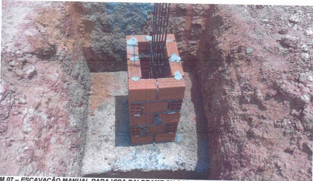
IMAGEM 07 – ESCAVAÇÃO MANUAL PARA VIGA BALDRAME OU SAPATA CORRIDA; PREPARO DE FUNDO DE VALA COM LARGURA MAIOR OU IGUAL A 1,5 M E MENOR QUE 2,5 M; LASTRO DE CONCRETO MAGRO, APLICADO EM BLOCOS DE COROAMENTO OU SAPATAS; ARMAÇÃO DE ESTRUTURAS DIVERSAS DE CONCRETO ARMADO, EXCETO VIGAS, PILARES, LAJES E FUNDAÇÕES, UTILIZANDO AÇO CA-50 DE 10,0 MM; CONCRETAGEM DE SAPATA, FCK 30 MPA
