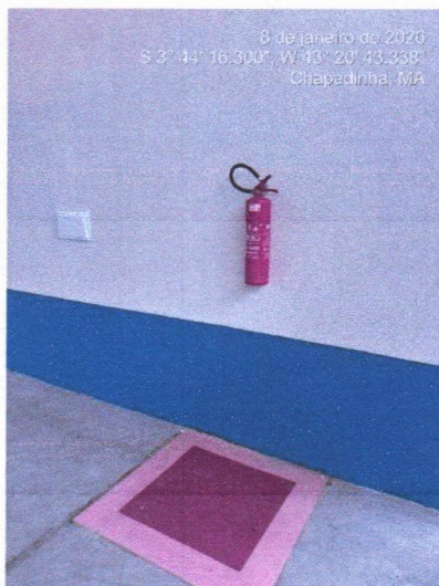
IMAGEM 13: quadro de distribuição e extintor de incêndio
