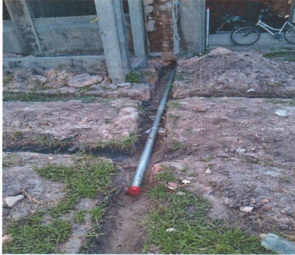
Tubulação Combate a Incêndio
