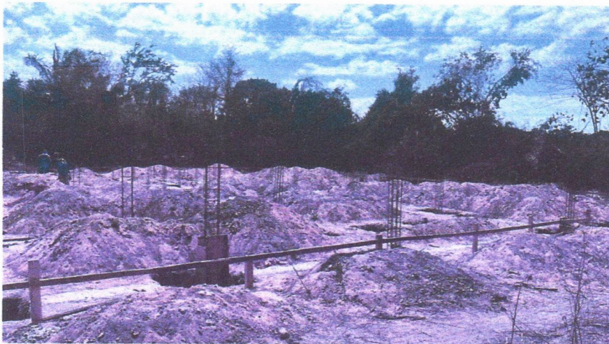
Imagem 3 – Execução do gabarito da obra, escavações das fundações, alicerce com pedra argamassada, e concretagem das sapatas.
