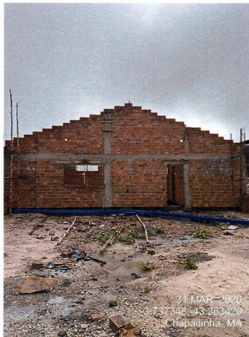
Imagem 4 – Execução da alvenaria do bloco da cozinha e concretagem dos pilares e vigas.
