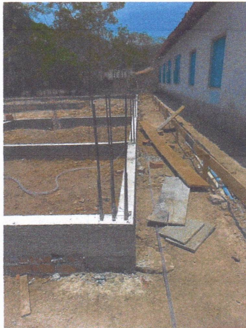
Imagem 8 – Execução da concretagem das vigas baldrames e armação dos arranque dos pilares.
