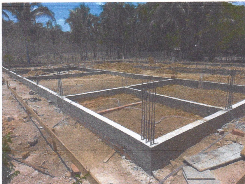
Imagem 5 – Execução da concretagem das vigas baldrame e armação dos arranque dos pilares.
