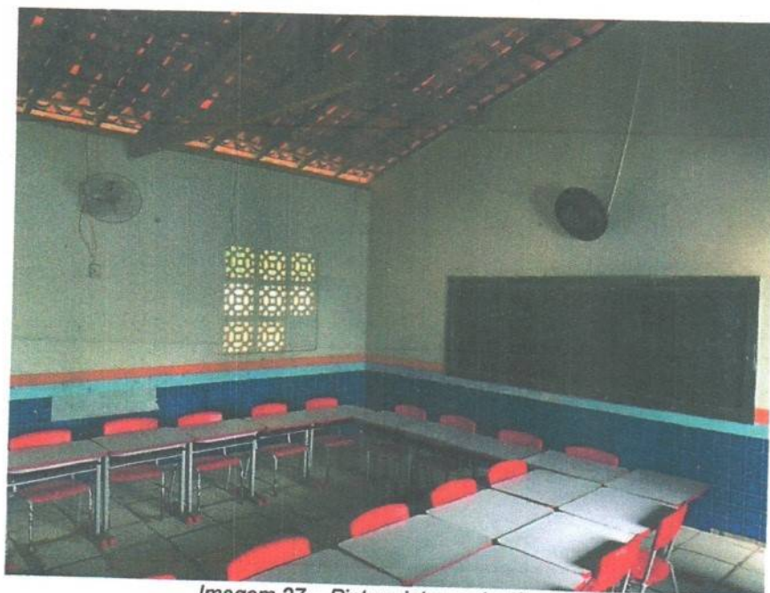
Imagem 27 – Pintura interna danificada
