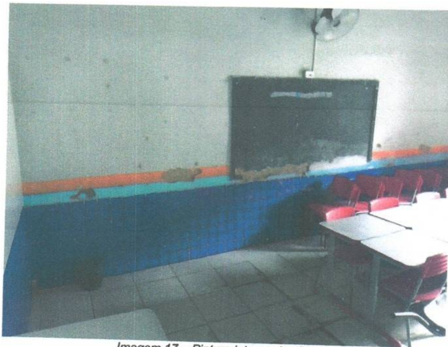
Imagem 17 – Pintura interna danificada
