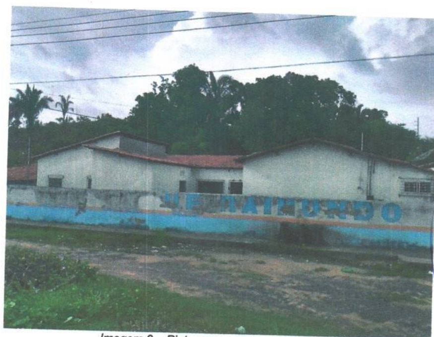
Imagem 2 – Pintura muro externo danificada
