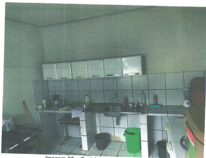
Imagem 23 – Cozinha com pintura danificada
