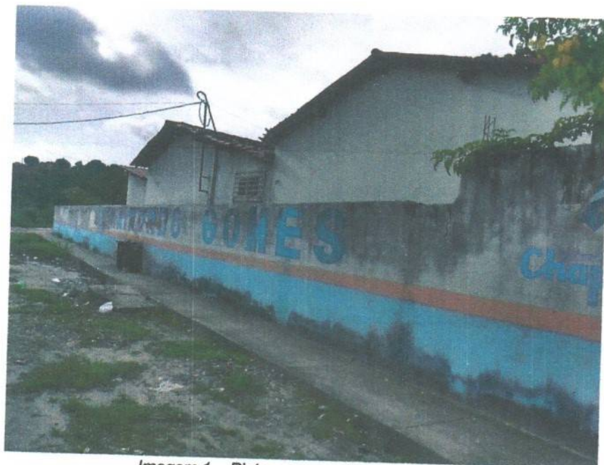
Imagem 1 – Pintura muro externo danificada
