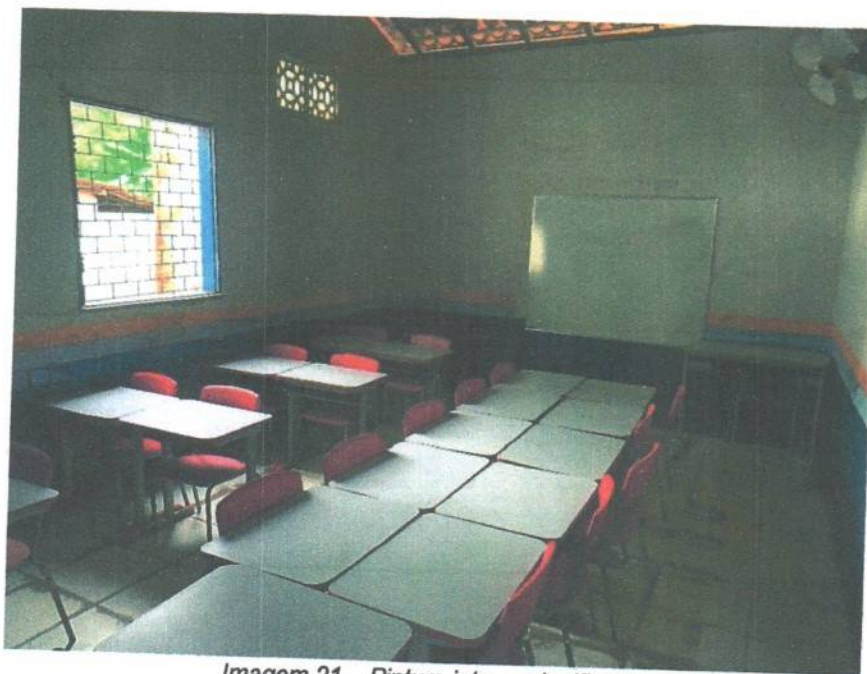
Imagem 21 – Pintura interna danificada
