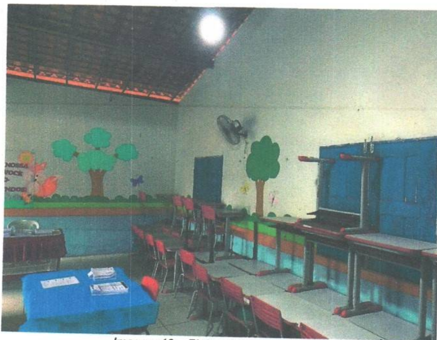
Imagem 19 – Pintura interna danificada
