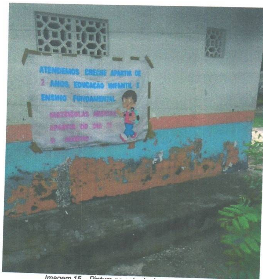
Imagem 15 – Pintura na entrada da escola danificada
