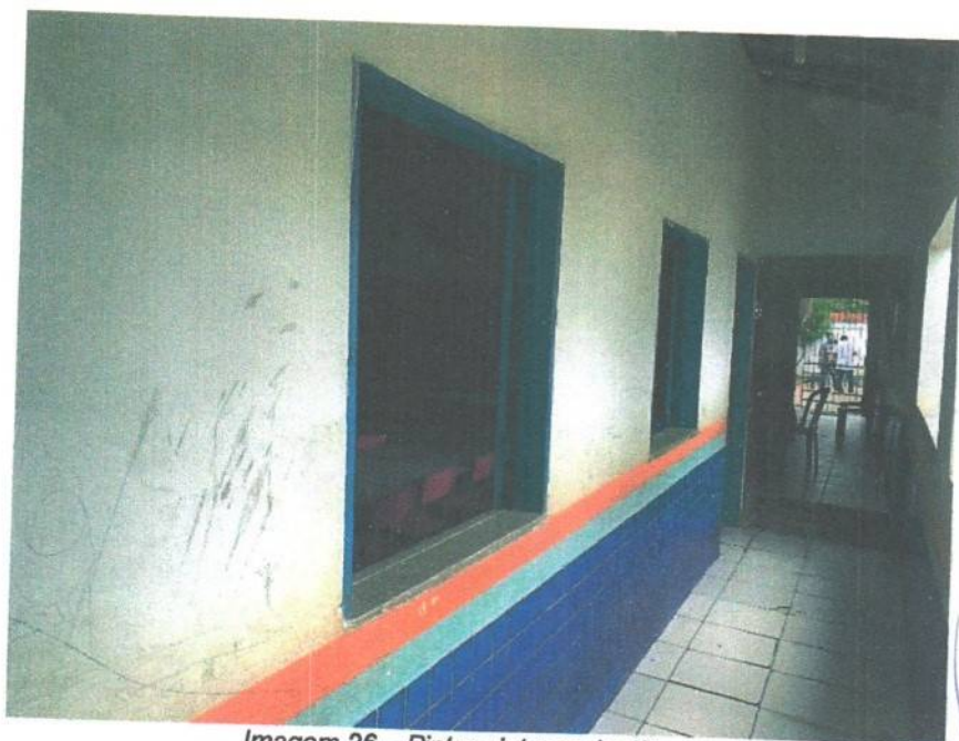
Imagem 26 – Pintura interna danificada
