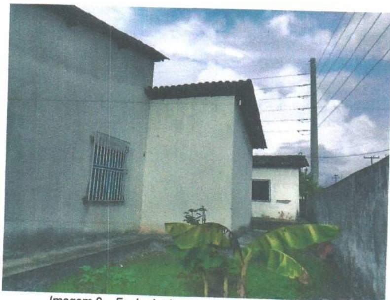
Imagem 9 – Fachada da escola com pintura danificada
