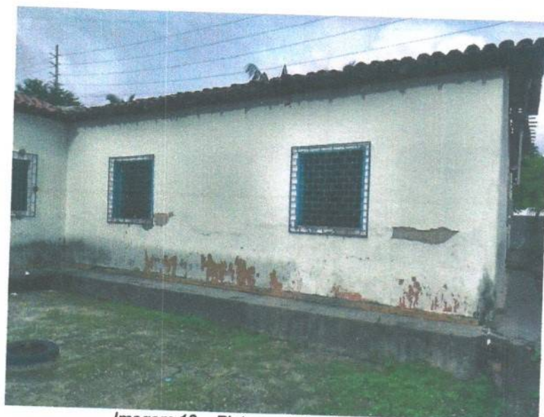
Imagem 13 – Pintura e telhado danificados
