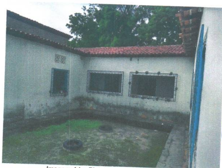
Imagem 14 – Pintura e telhado danificados
