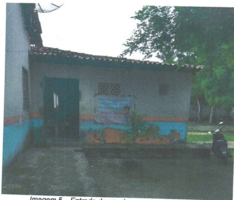
Imagem 5 – Entrada da escola com pintura danificada
