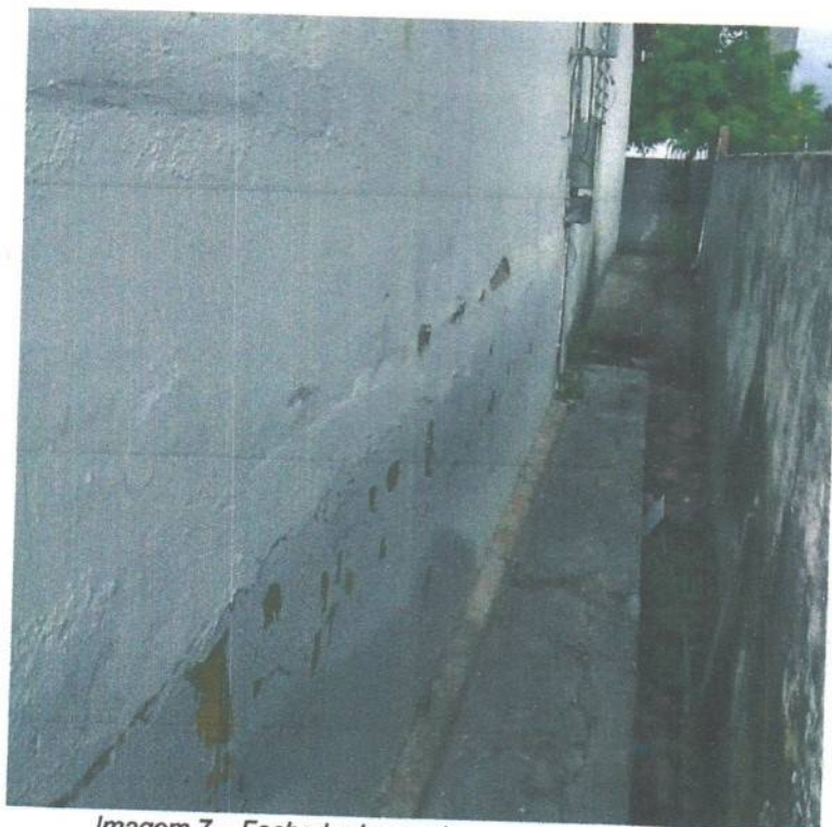
Imagem 7 – Fachada da escola com pintura danificada
